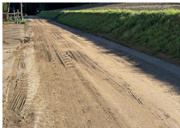
Coulée de boue à la Route de Béthusy
