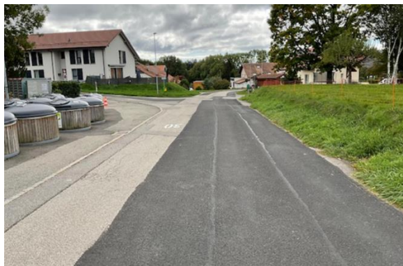
Travaux de colmatage des revêtements routiers - Rue de la Maison de Ville
