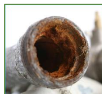
Tuyau en fer (bâtiments anciens)
